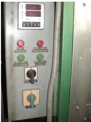
Slika21, Peć za termičku obradu-upravljački dio
